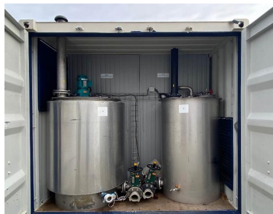
Figure 8 : Hygiénisateur (à gauche) / Cuve de stockage tampon (à droite)
